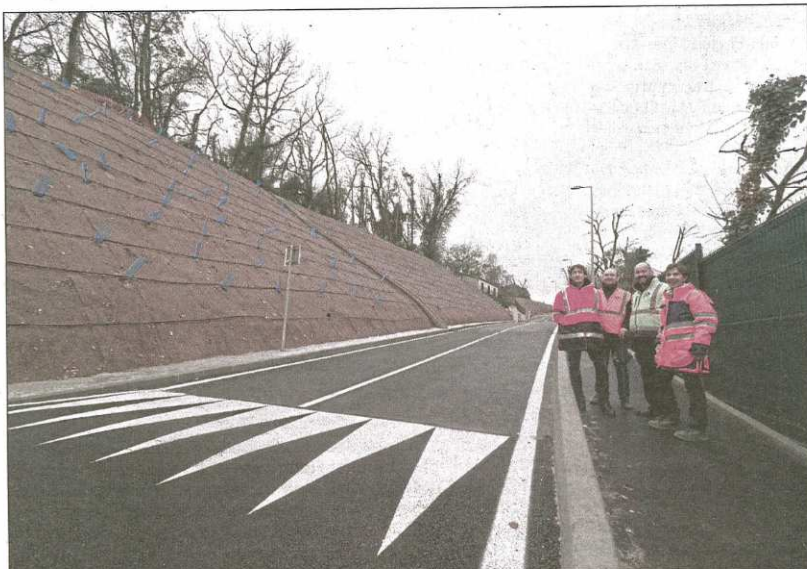
Laurent Tuduri, Jacques Thomas, Frank Alani et Isabelle Colombat : ils sont tous intervenus sur ce chantier innovant. La membrane de soutien du talus est un maillage métallique allié à de la fibre de coco. (Photos J-S G.-A.)
