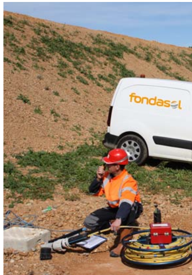
→ Suivi des tassements sous un remblai par mesure au profilomètre hydrostatique
