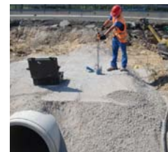
→ Réception d'un remblai contigu par essai au pénétromètre dynamique à énergie variable
